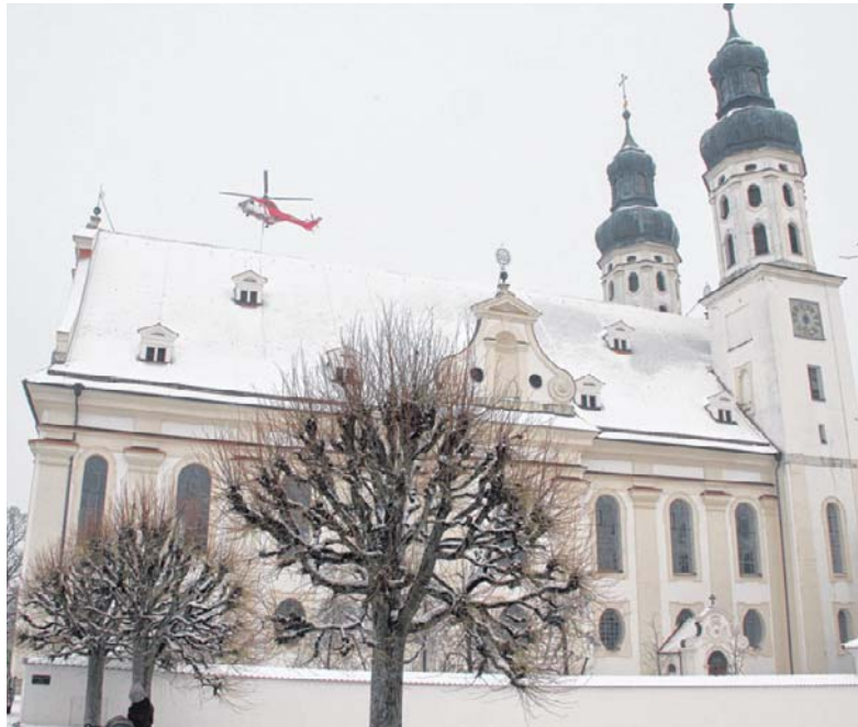
Barock trifft moderne Technik: Am Kloster Obermarchtal hat ein Team von Fachleuten mithilfe eines Helikopters Bäume gefällt. SZ-FOTOS: WISMATH
